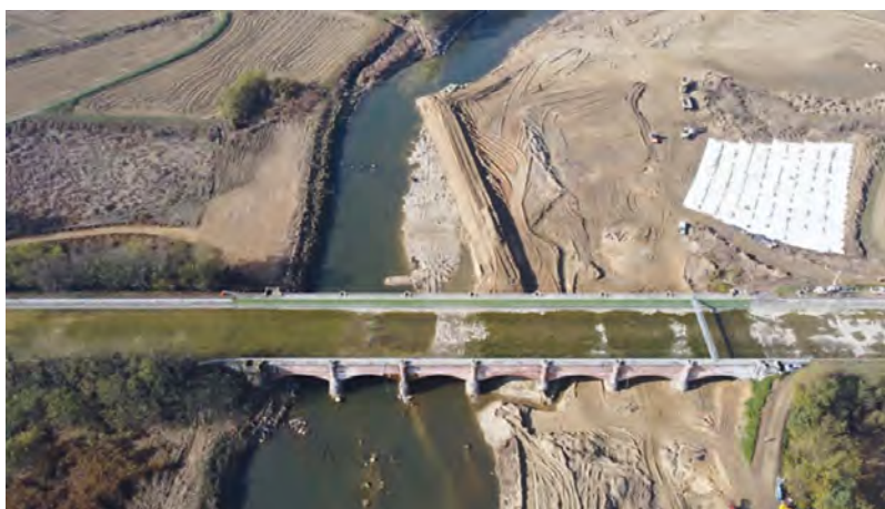
Fig. 1. Un ponte con ben quattro delle sette campate ostruite dai detriti trasportati dall'acqua.
